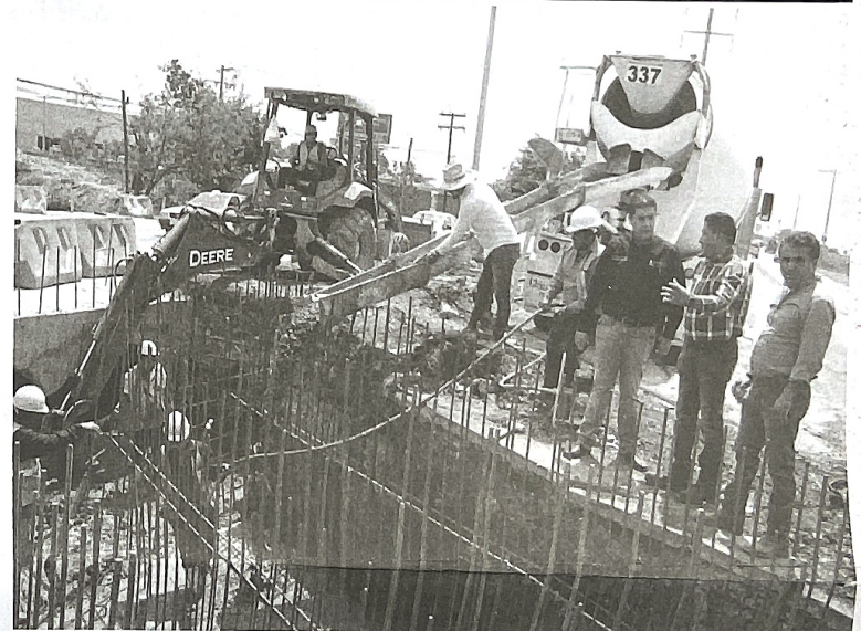
La Administración del Edil Lic. Francisco Héctor Treviño Cantú seguirá realizando este tipo de obras para preservar la seguridad e integridad de los Juarenses y proteger su patrimonio evitando inundaciones futuras debido a las lluvias.
